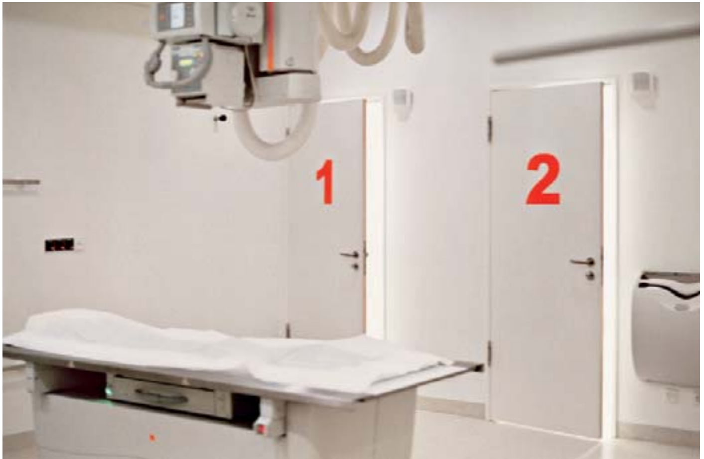
Untersuchungsbereich in der Frankfurter Radiologie: Vom Wirken der HOST-Experten, die hinter den Kulissen die hochkomplexen Anlagen betriebsbereit halten, bekommen die Patienten des Klinikums nichts mit
