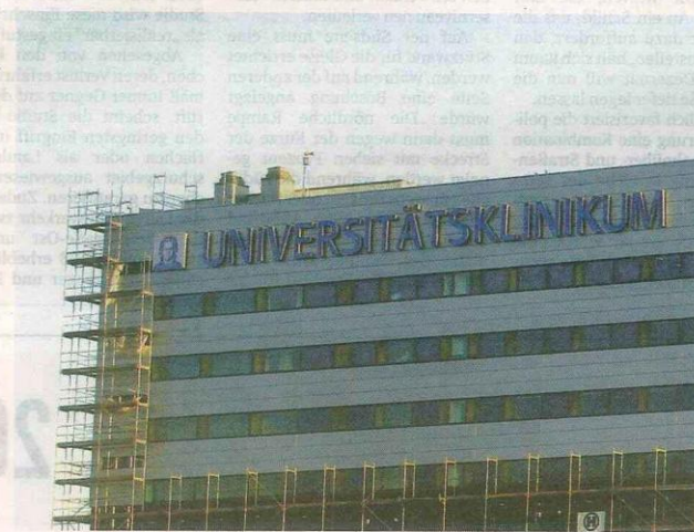
Auch während der Bauarbeiten ist eine professionelle medizinische Versorgung der Patienten im Frankfurter Universitätsklinikum gewährleistet.
